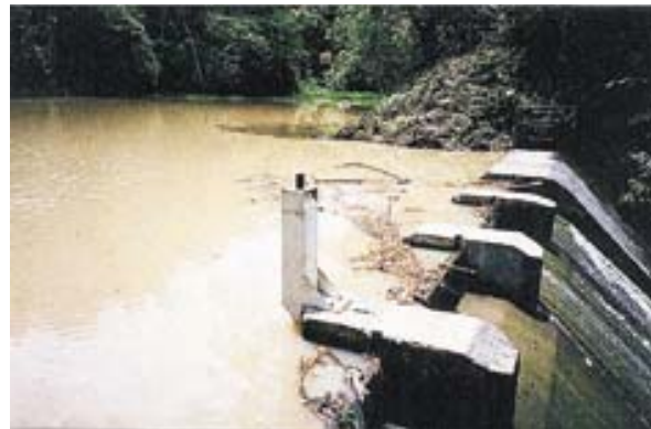
Figura 2. Toma de una central a filo de agua.
