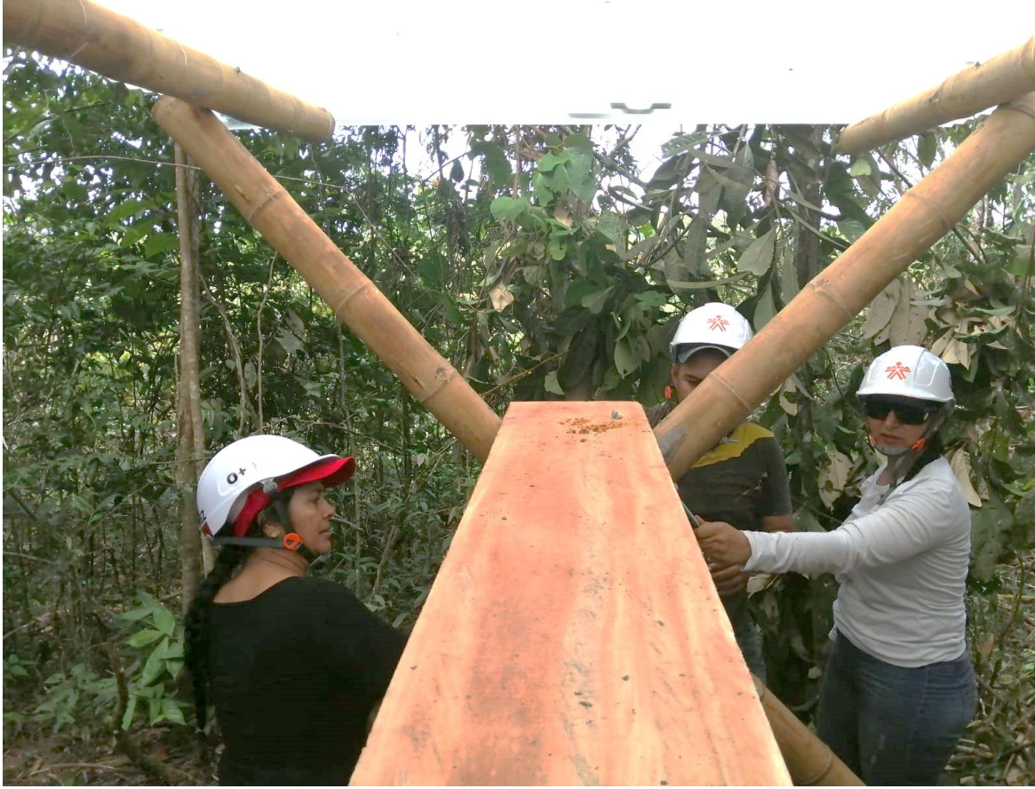
Figura 21. Montaje de estructura con aprendices del técnico en construcción y mantenimiento en estructuras de guadua
