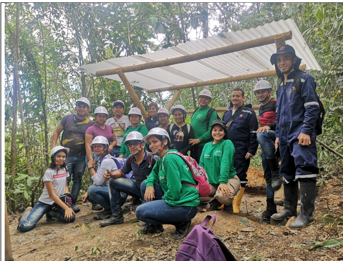
Figura 20. Aprendices e instructores culminando construcción de meliponario en la granja del SENA
