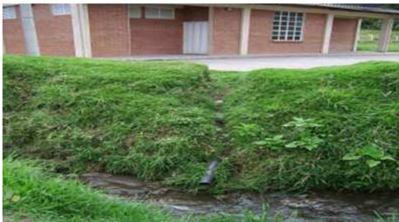
Figura 8. Descole de aguas residuales domésticas, directamente sobre el cuerpo de agua receptor sin ningún tipo de tratamiento
