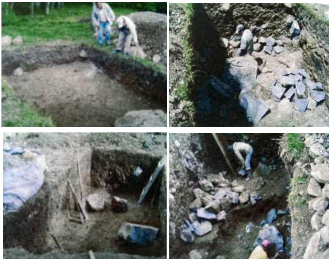
Figura 24. Descapote, excavación manual en material común y roca del tanque séptico y filtro anaerobio de flujo ascendente
