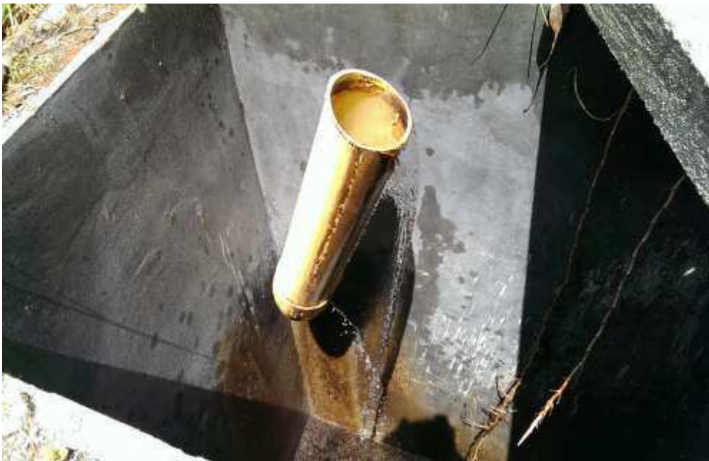
Figura 20. Cámara Toma de Muestra (CTM) final a la salida del Humedal Artificial
