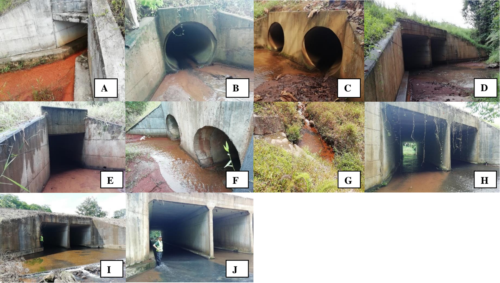
Anexo 2. Fotografías de las alcantarillas monitoreadas en Ruta 4, Sección Bajos de Chilamate – Vuelta Kooper. A. Alcantarilla modificada 1. B. Alcantarilla 2. C. Alcantarilla 3 D. Alcantarilla modificada 7. E. Alcantarilla 8. F. Alcantarilla 10. G. Alcantarilla 11. H. Alcantarilla 12. I. Alcantarilla modificada 13. J. Alcantarilla modificada 14.
