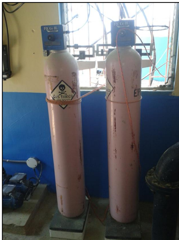
Figura 25.- Tanques de inyección de gas cloro
