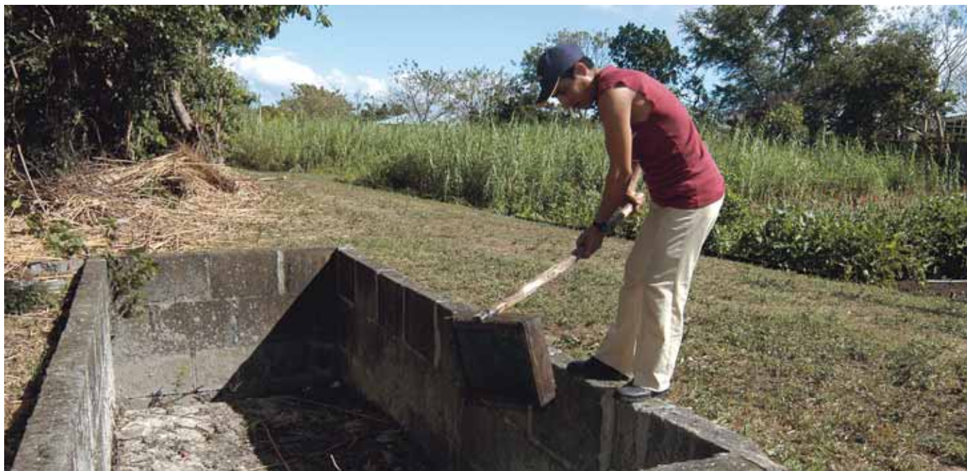
Operador vertiendo sólidos del canal de entrada en desecador de lodos
