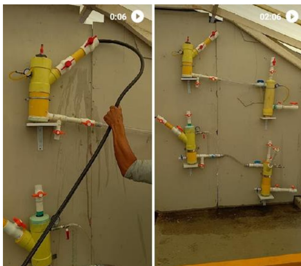
Fig. 24. Instalación en la PTAR de los reactores de dos etapas
