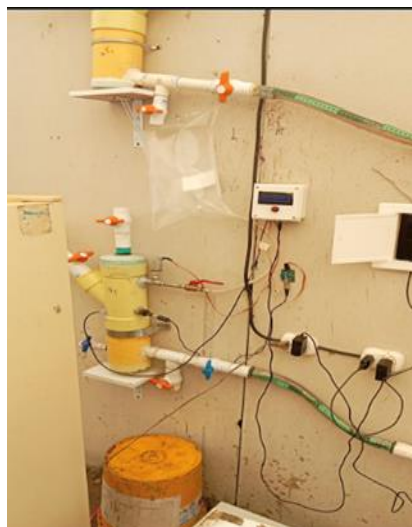
Fig. 73. Ubicación de sensores y cableado de reactores.
