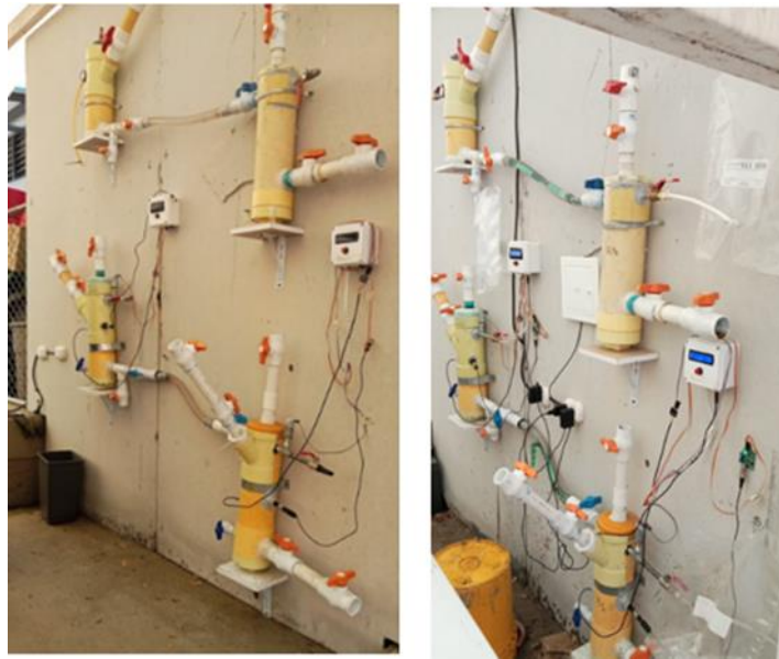
Fig. 25. Instalación en la PTAR de los reactores de dos etapas
