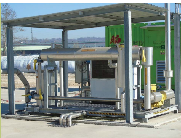
Imagen 8. Sistema chiller /enfriamiento para secado del biogás
