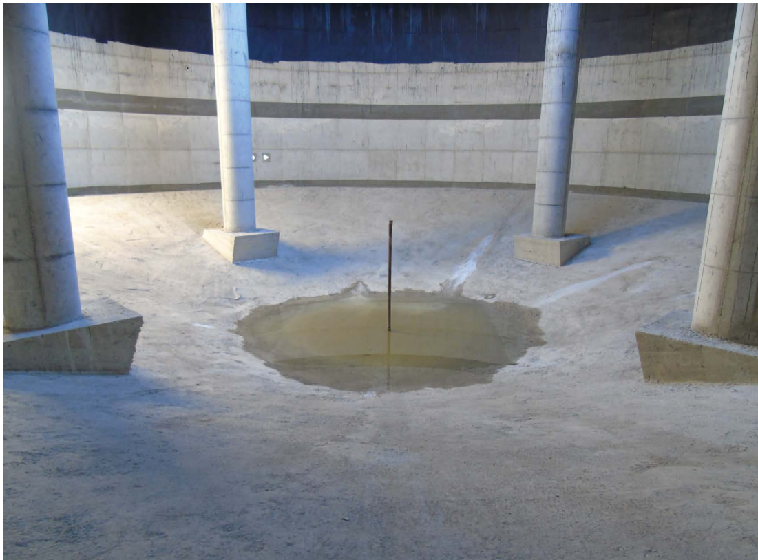
Imagen 17. Interior de un digestor de hormigón con protección epoxi en la parte superior
