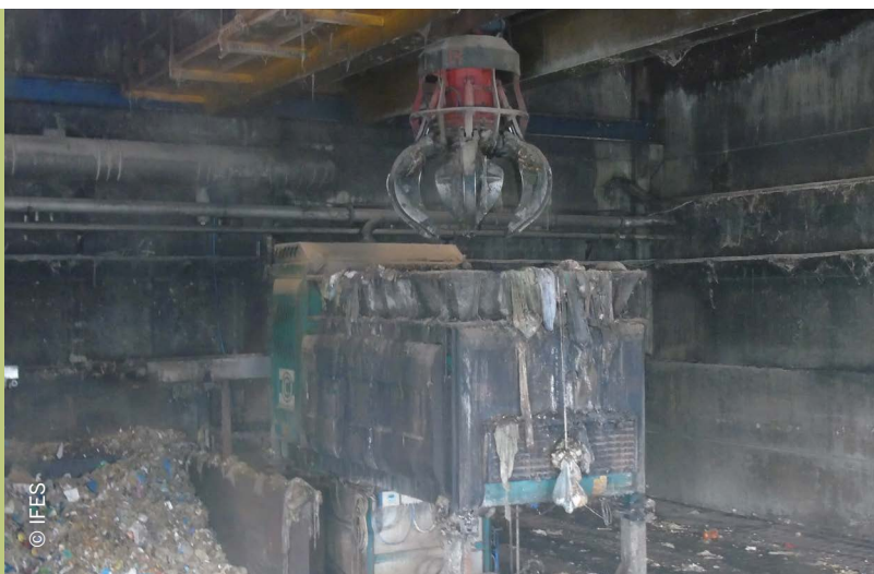
Imagen 24. Sistema de limpieza de FORSU, pretratamiento para envío del sustrato a tanque de precarga
